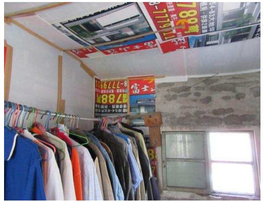
原房間漏水僅先以廣告板阻隔
